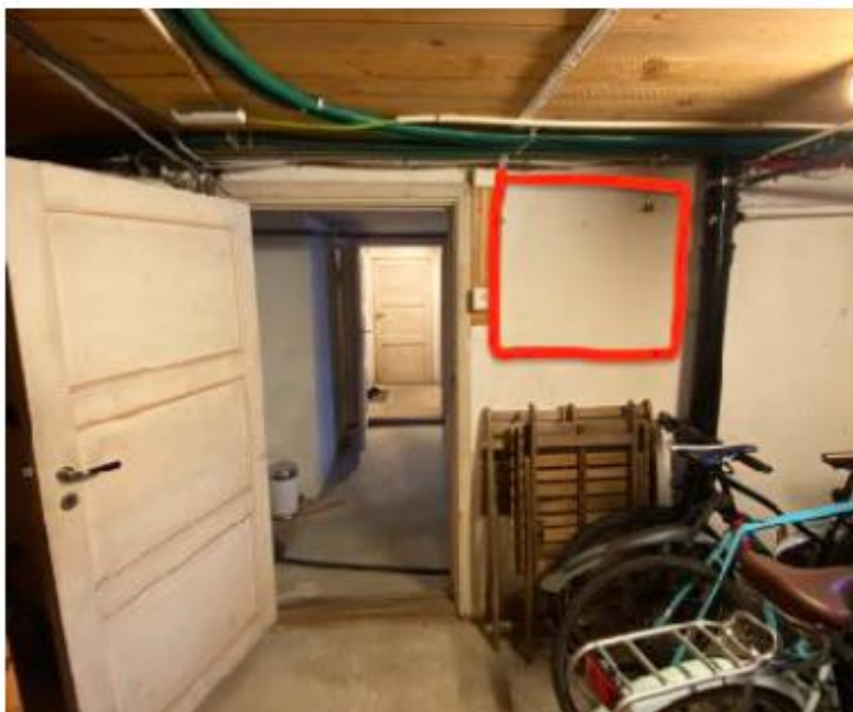
Bilde 2 og 3: Alternativer til plassering av strømskap.
